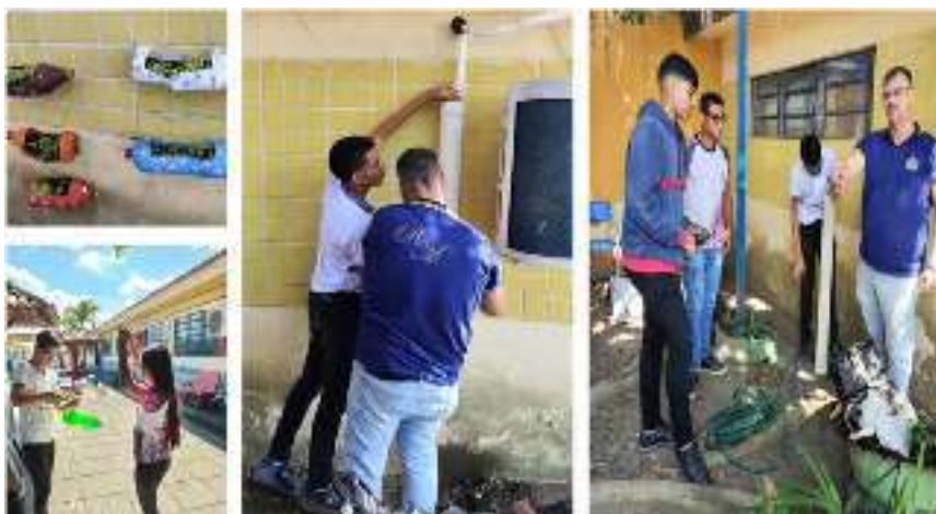
Figura 3 – Instalação e implementação dos componentes de coleta de água do ar-condicionado, das hortas suspensas com garrafas PET e do uso de fertilizantes secos e líquidos provenientes das compoteiras de garrafas PET.
